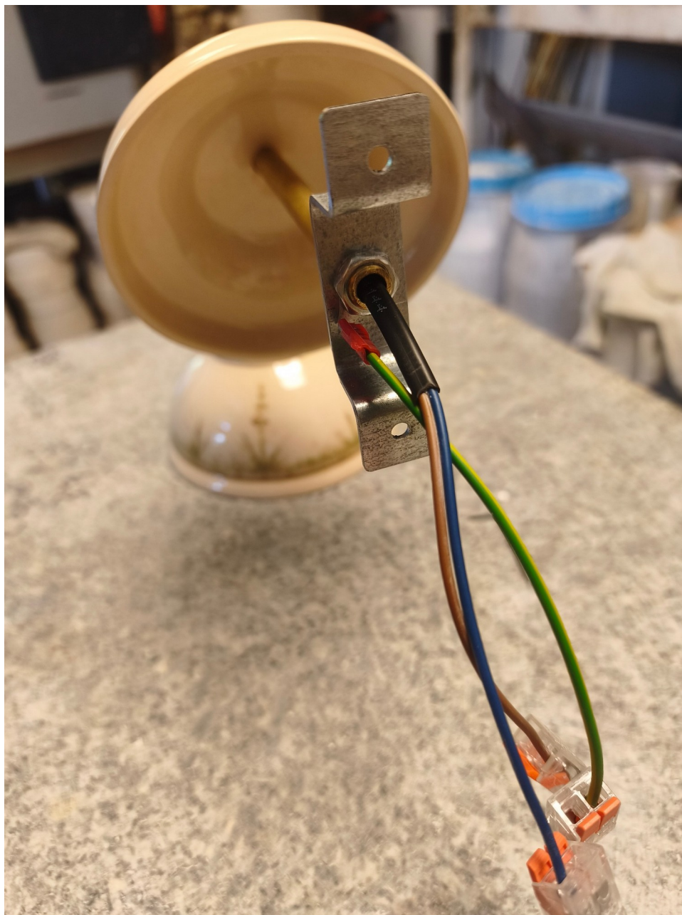
3. kép - A lámpatest vezetékei és a fém konzol védővezető-csatlakozása.
